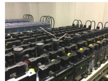
直流電源装置 (蓄電池 据置型)
