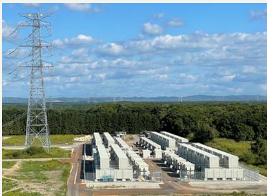
I期蓄電池 外観▶
