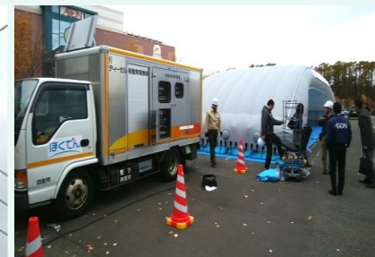
移動発電機車による電力供給
