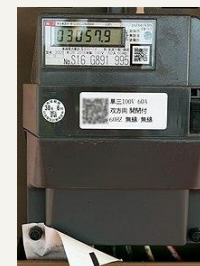
スマートメーター
