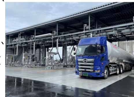
タンクローリー向け出荷設備
