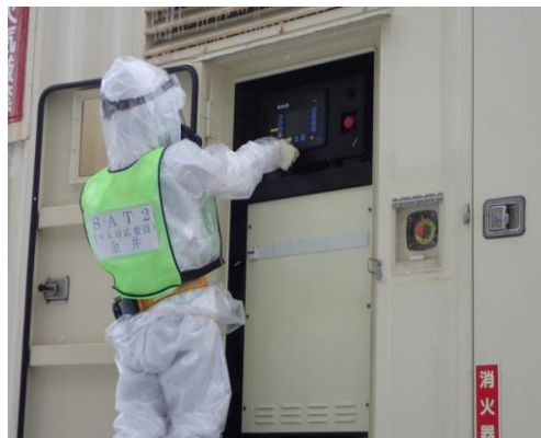
電源車起動訓練
