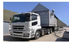
代替非常用発電機
