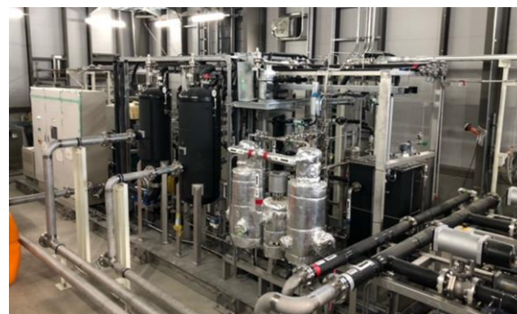
水素製造装置
