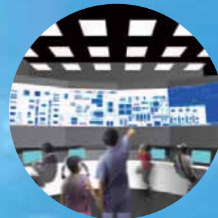
⑤中央制御室
