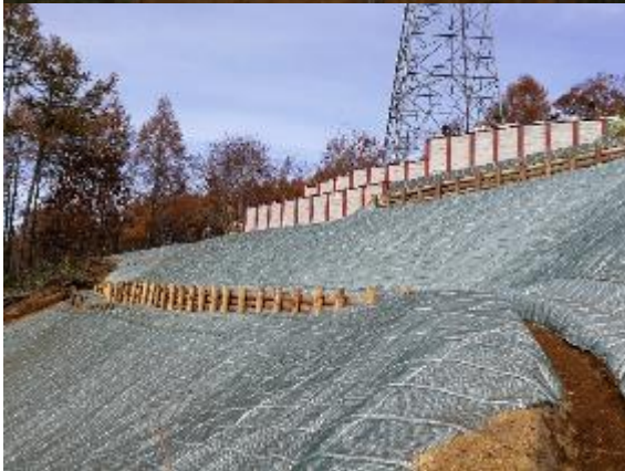
擁壁※による土留め対策
