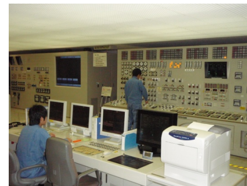
中央操作室での監視状況
