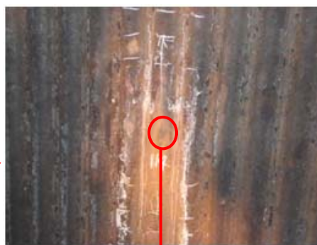
<損傷箇所 (蒸発管) 概要>
