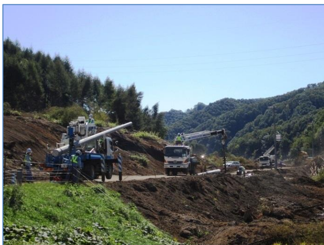
道路が復旧した箇所から順次復旧作業を進める（厚真町）
