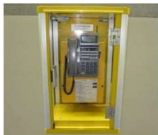
運転指令設備（警報装置を含む）
