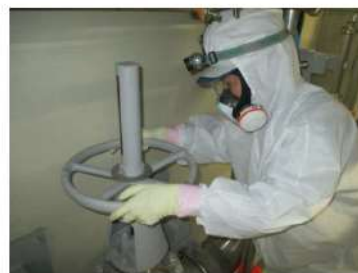
燃料取替用水ピット 水源切替系統構成 (原子炉補助建屋 T.P. 10. 3m) (作業風景は類似作業)
