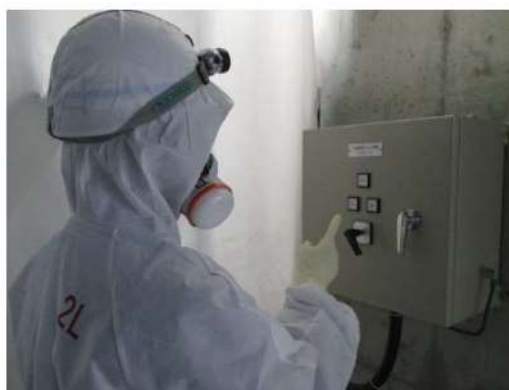
代替格納容器スプレイポンプ起動操作 (原子炉補助建屋 T. P. 10. 3m) (作業風景は類似作業)
