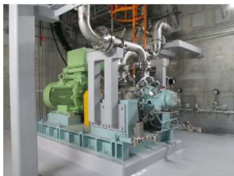
代替格納容器スプレイポンプ (原子炉補助建屋 T. P. 10. 3m) (写真はイメージ)
