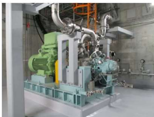
代替格納容器スプレイポンプ (原子炉補助建屋 T.P. 10. 3m) (写真はいメージ)
