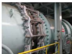
循環水管伸縮継手
