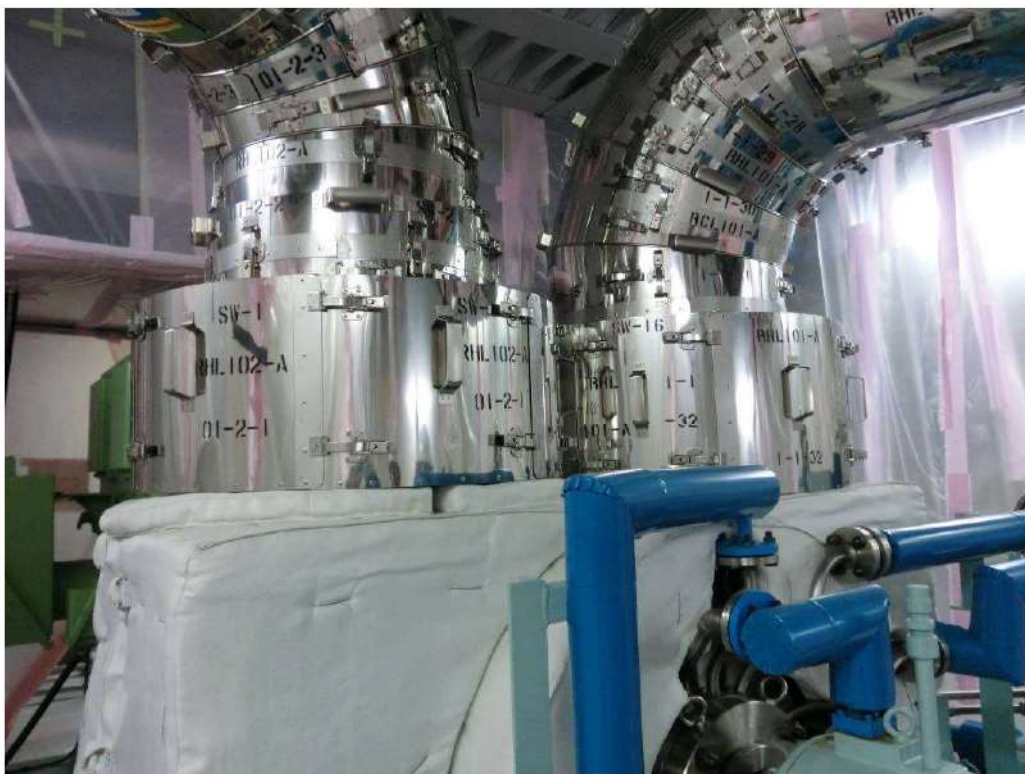
余熱除去ポンプ 配管周辺部
