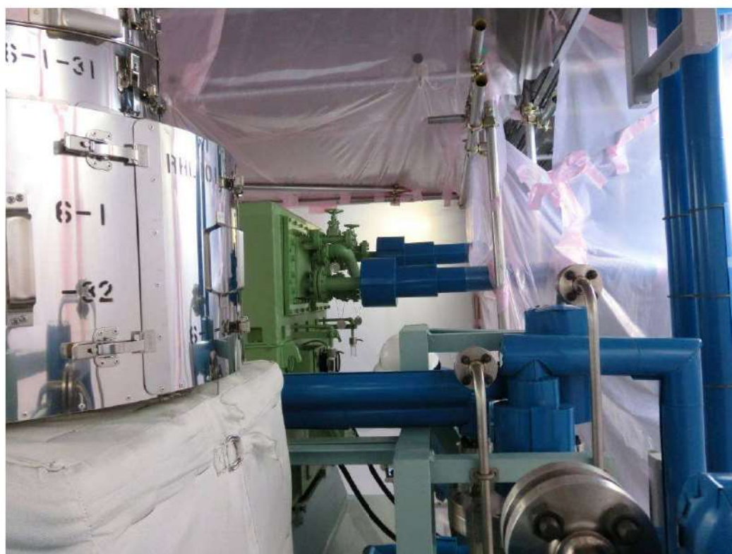
余熱除去ポンプ 周辺状況
