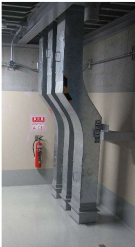
第 2-1 図 ケーブルトレイ床貫通部外観
