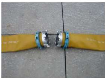
可搬型ホース(150A)接続口
