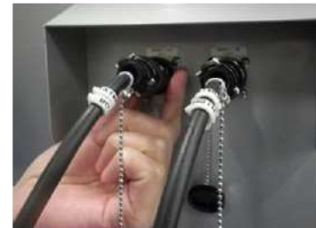
検出器用ケーブル接続
