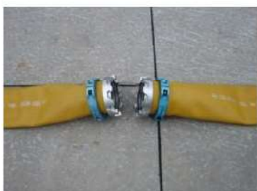
可搬型ホース(150A)接続口
