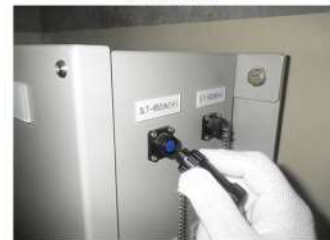
ケーブル接続 BOX
