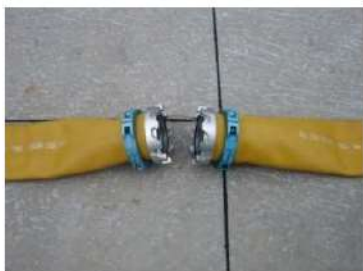
可搬型ホース(150A)接続口
