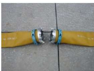
可搬型ホース (150 A) 接続口
