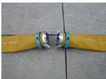
可搬型ホース (150A) 接続口
