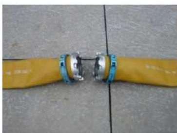
可搬型ホース (150 A) 接続口
