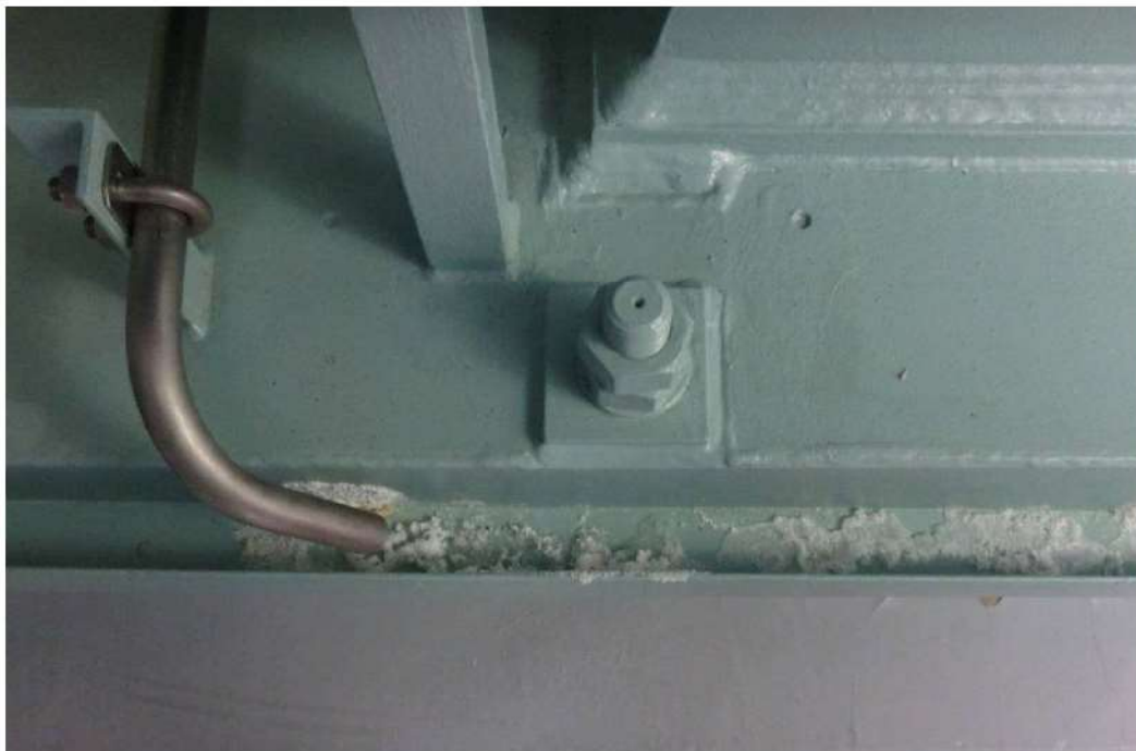
余熱除去ポンプ 据付部
