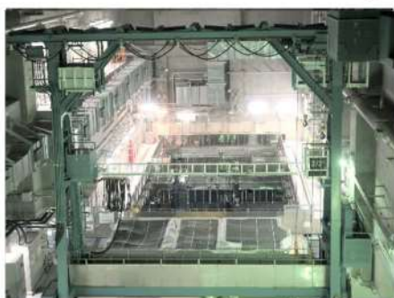
使用済燃料ピットクレーン
