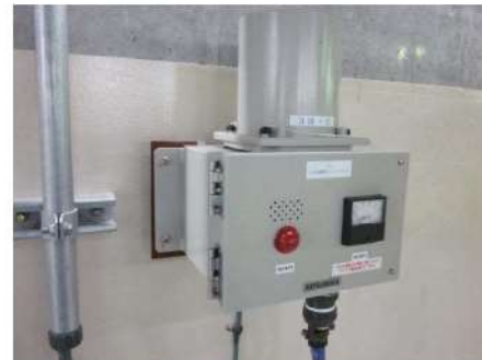
機器の固定状況
