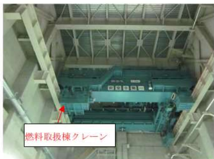
燃料取扱棟クレーン
