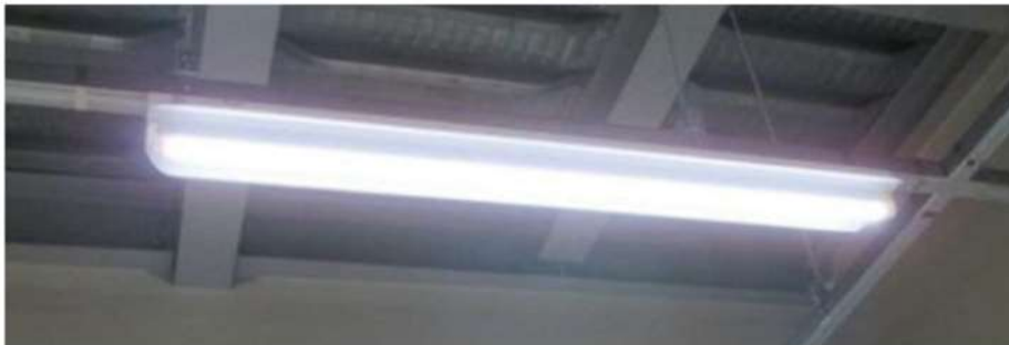
無停電運転保安灯
