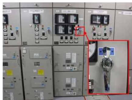
電源盤の施錠
