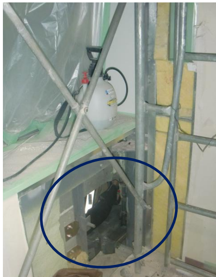
発煙確認場所（執務室側から撮影）
