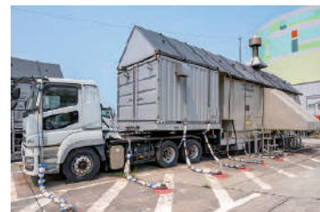
代替非常用発電機(常設)
