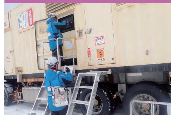
電源車起動訓練
