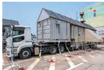
代替非常用発電機（常設）
