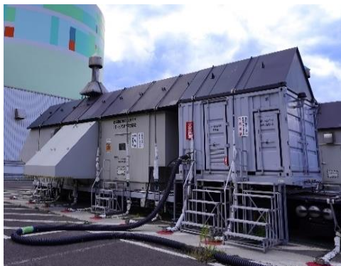
代替非常用発電機（常設）
