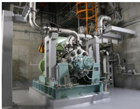
代替格納容器スプレイポンプ（常設）
