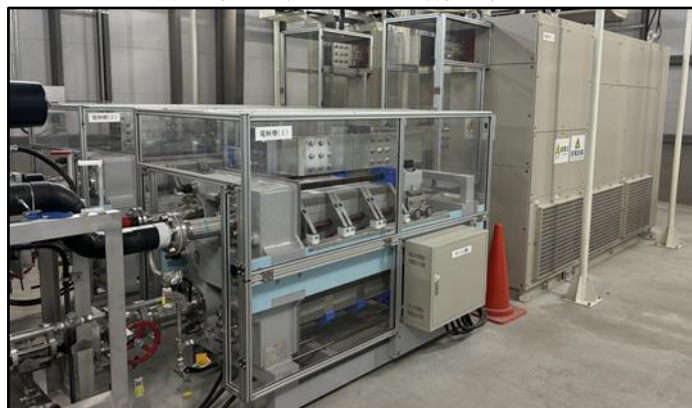
水素製造装置（PEM型水電解装置）の外観
