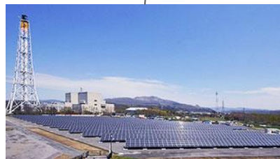
伊達ソーラー発電所(太陽光)
