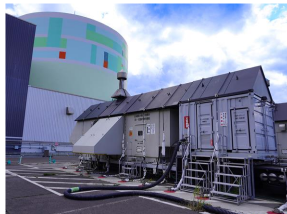
代替非常用電源
