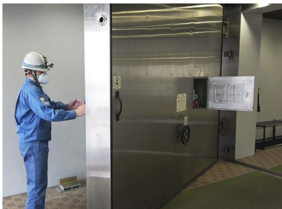
水密扉の設置
