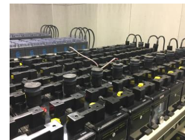
直流電源装置 (蓄電池据置型)
