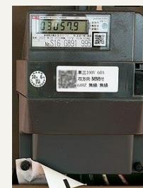
スマートメーター
