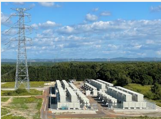
I期蓄電池 外観▶
