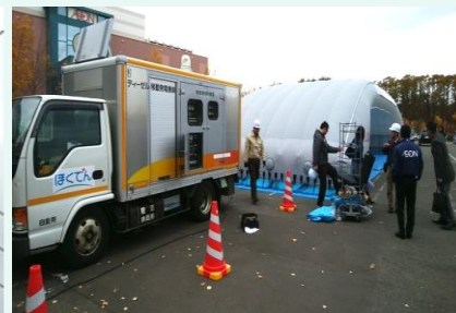
移動発電機車による電力供給
