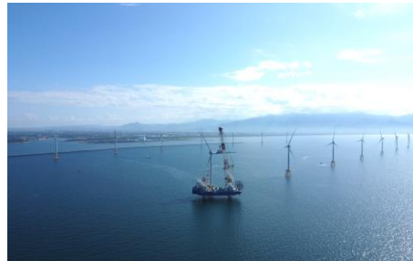
【発電所の全景】
