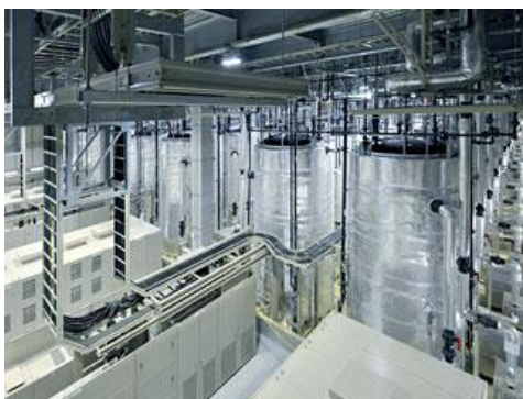
▲蓄電池の電解液タンク・電力変換装置
