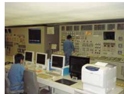
中央操作室での監視状況
