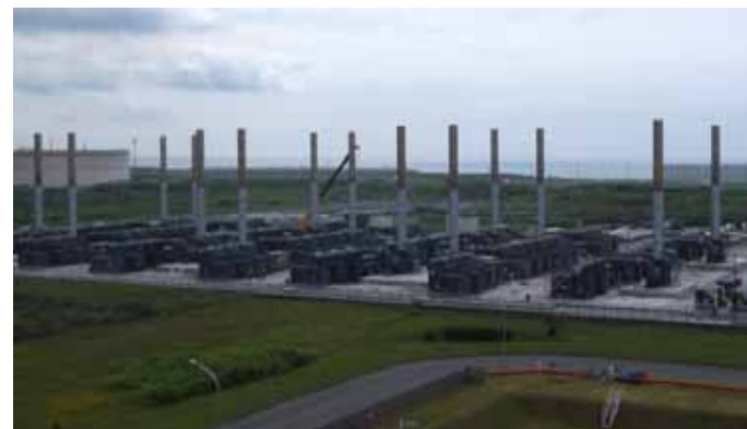
【緊急設置電源（苫小牧発電所）】
