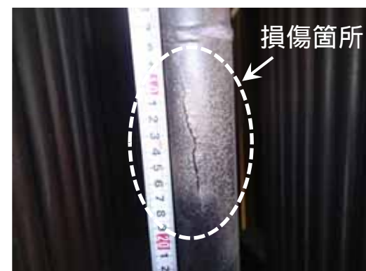
【写真】 再熱器管損傷状況
