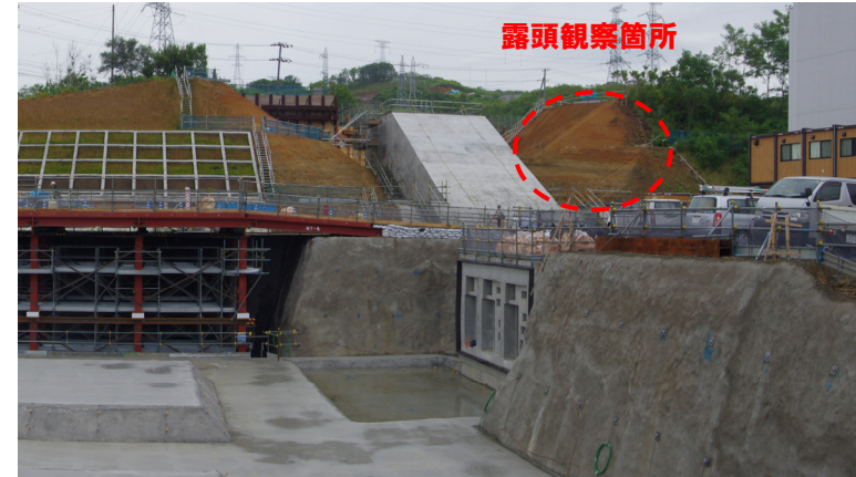
露頭全景 (平成26年)
