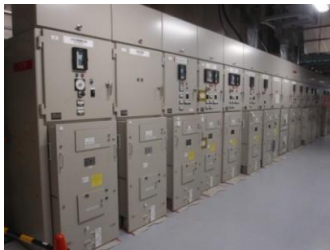
機器：メタクラ 種類：真空遮断器
