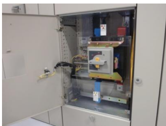
機器：直流コントロールセンタ 種類：配線用遮断器
