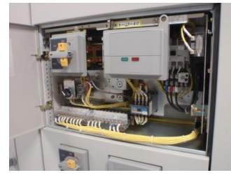
機器：コントロールセンタ 種類：配線用遮断器
