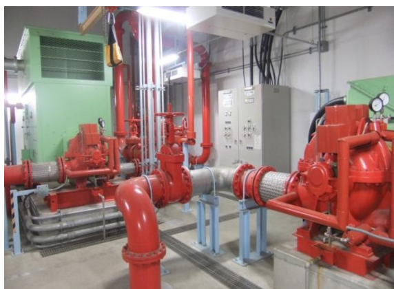
ディーゼル駆動消火ポンプ (給排水処理建屋内)
