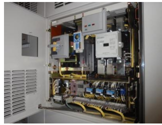
機器：パワーコントロールセンタ 種類：配線用遮断器
