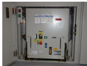
機器：原子炉トリップ 遮断器 種類：気中遮断器
