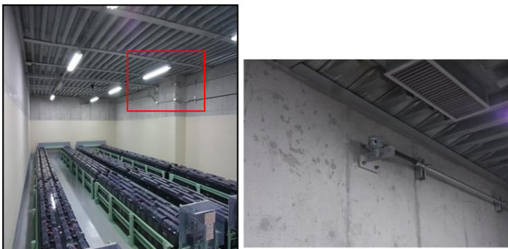
水素漏えい検知器（蓄電池室）
