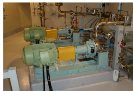
格納容器冷却材ドレンポンプ
