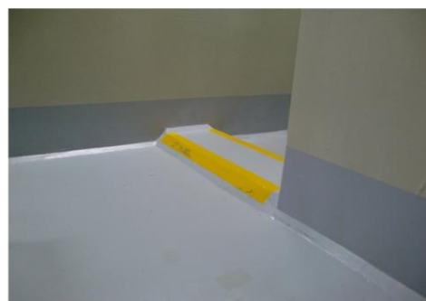
堰 (ほう酸ポンプ室出入口)
