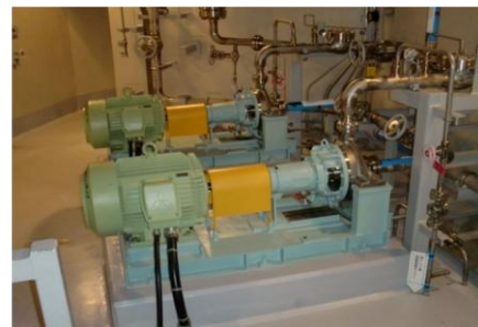
格納容器冷却材ドレンポンプ
