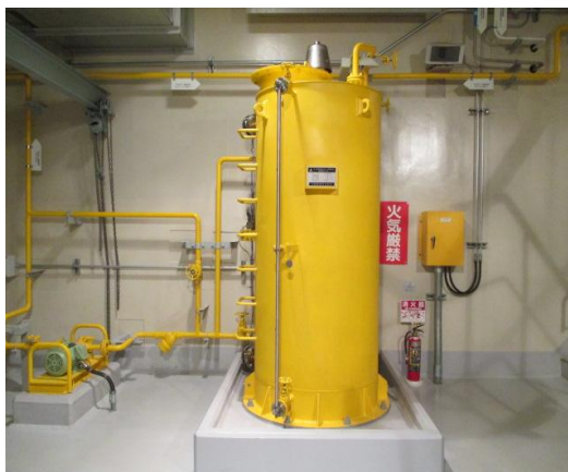
【1次冷却材ポンプ電動機油回収タンク】 (電動機1台の全油量1.0m 3 を全量回収可能な容量1.5m 3 )
