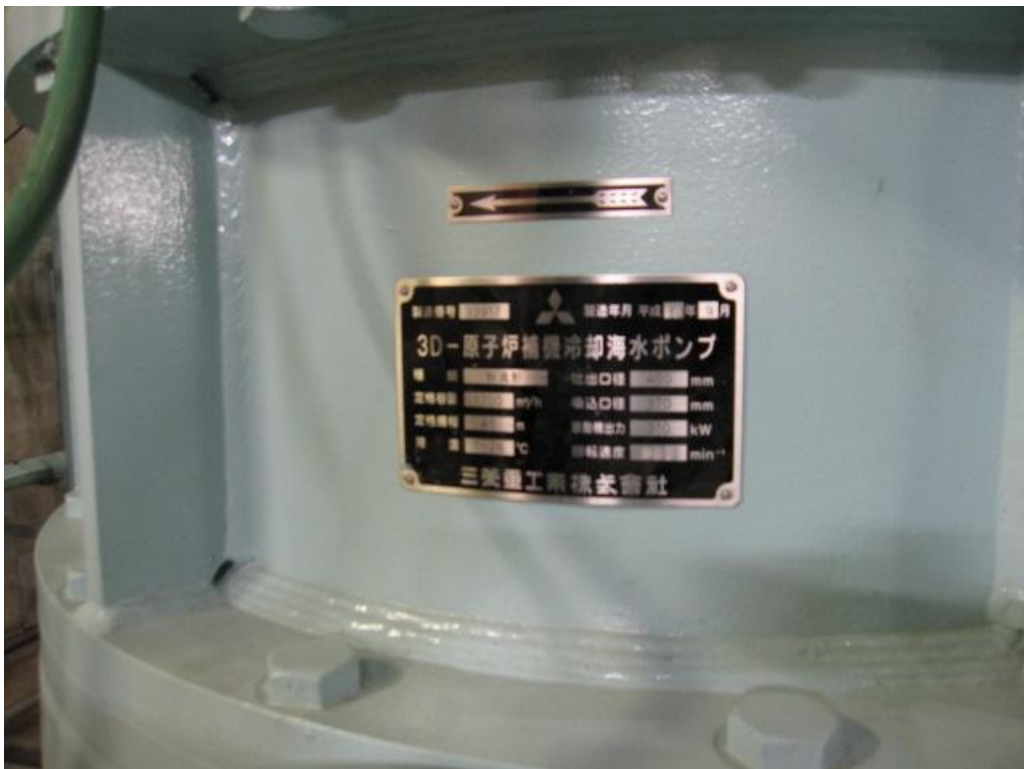
第 3.3-4 図 現場写真（原子炉補機冷却海水ポンプ）
