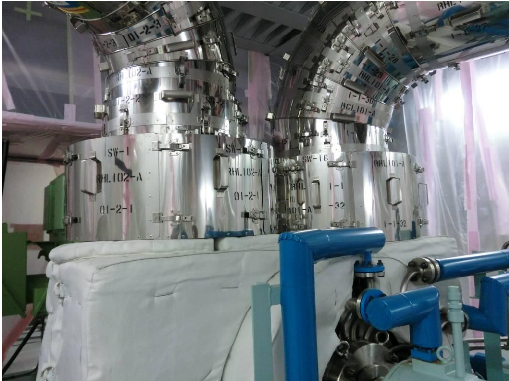
余熱除去ポンプ 配管周辺部
