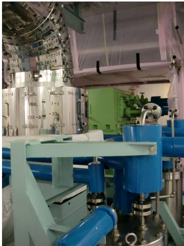
余熱除去ポンプ 外観
