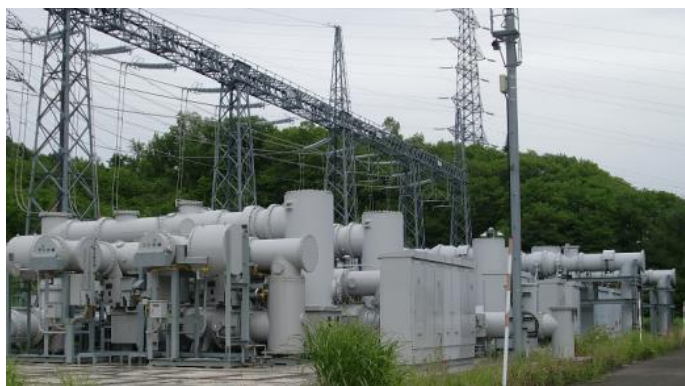
図－18 西野変電所
