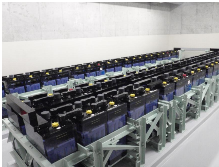
図-14 直流電源（蓄電池）
