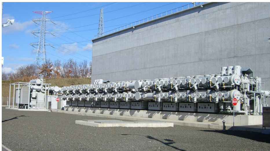
図－10 275kV開閉所（GIS）
