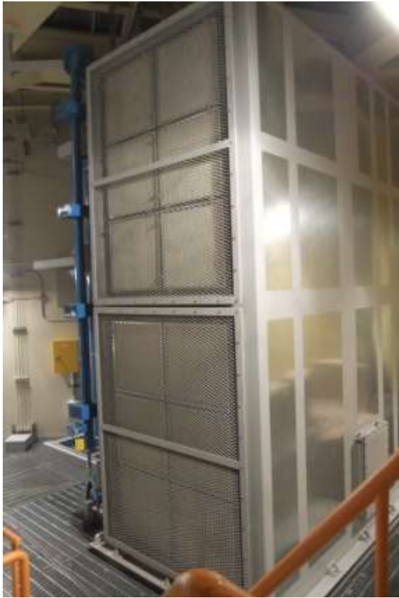
格納容器再循環ユニット
