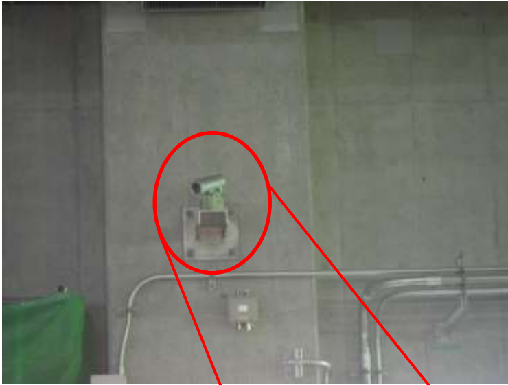
(a) 使用済燃料ピット監視カメラ設置状況（原子炉建屋 T.P. 33. 1m より+5m の高さに設置）
