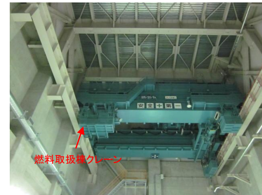
燃料取扱棟クレーン
