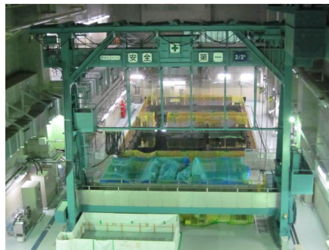
使用済燃料ピットクレーン
