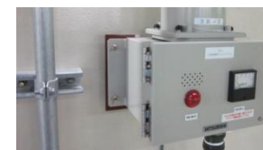
機器の固定状況
