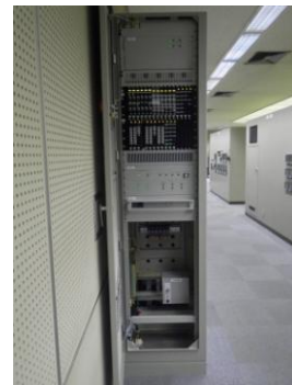
A T W S 緩和設備（共通要因故障対策盤）
