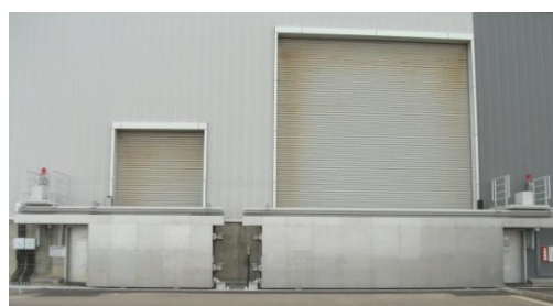
<3号機循環水ポンプ建屋入口防潮扉>
