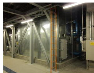
空調ユニット
