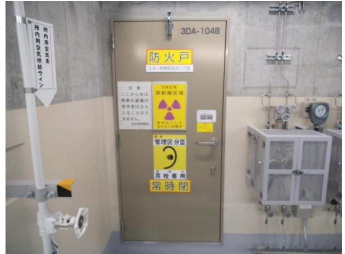
(8) A-余熱除去ポンプ室扉
