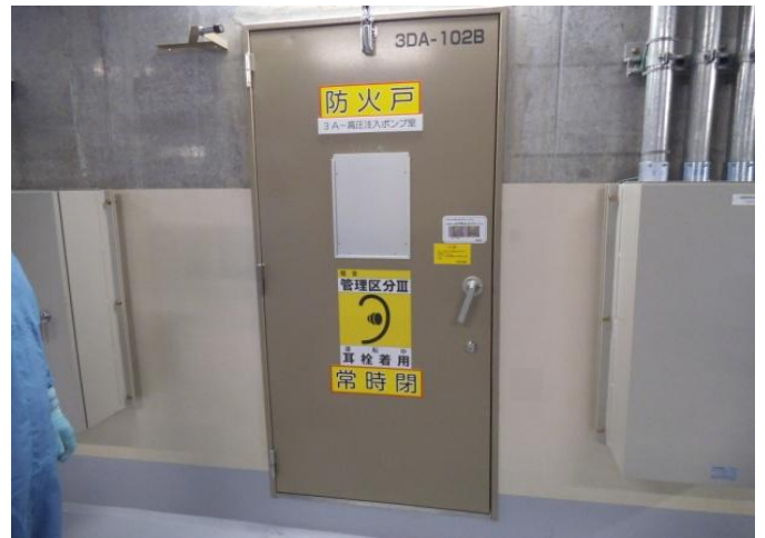
(4) A-高圧注入ポンプ室扉
