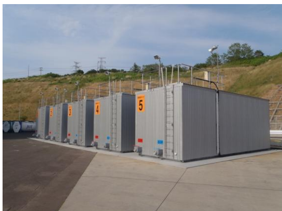
図1 代替屋外給水タンク
