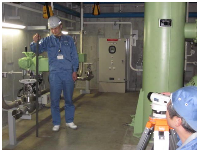
図-1 弁類（制御用空気Cヘッド供給弁）
