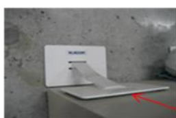
転倒防止処置
