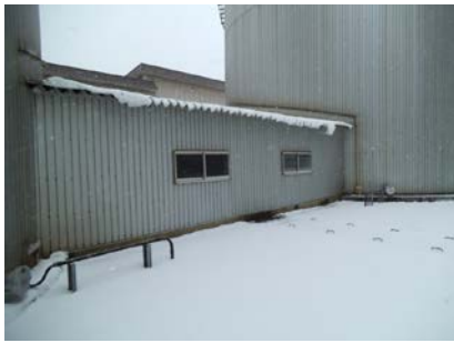
1・2号ろ過水タンク防雪小屋④
