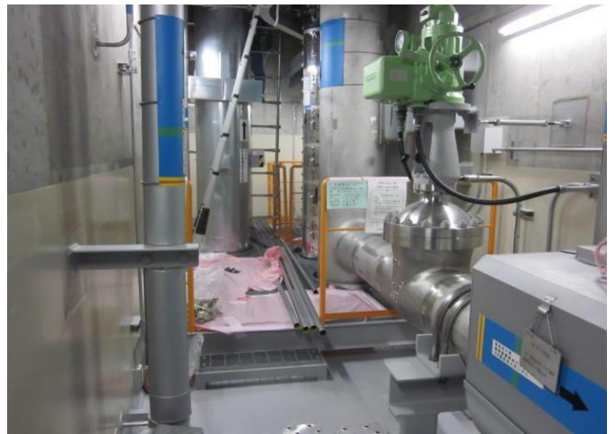
(2) B-安全補機配管室内
