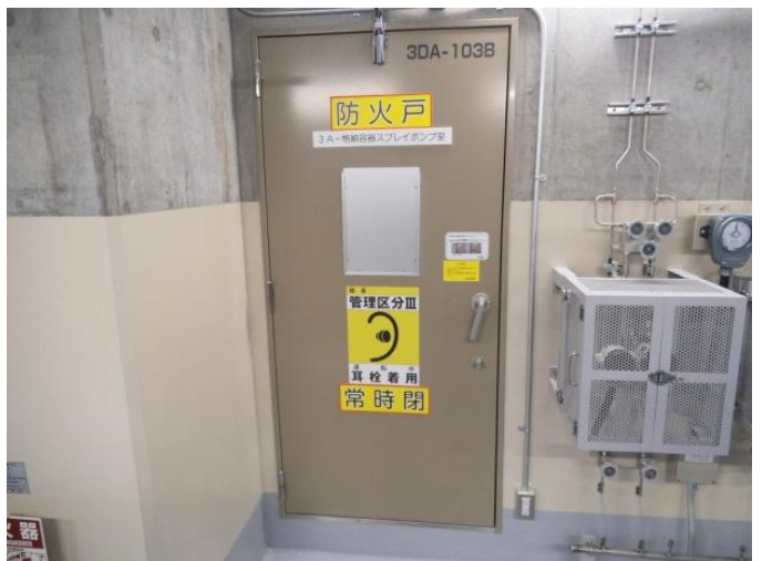
(6) A-格納容器スプレイポンプ室扉
