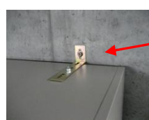
転倒防止処置
