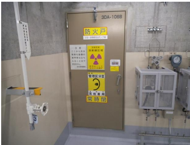
(9) B-余熱除去ポンプ室扉
