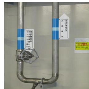
出入管理建屋 T. P. 6. 3m 洗濯設備室
