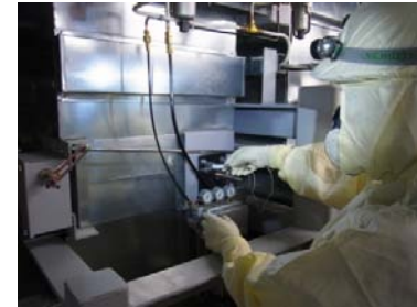
中央制御室換気系の空気作動ダンパ開操作教育訓練
