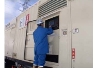
可搬型代替電源車給電手順 (可搬型代替電源車起動教育訓練)
