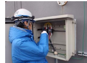
可搬型直流電源設備給電手順 (給電ケーブル接続教育訓練)
