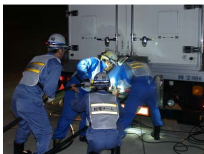
代替給電訓練
