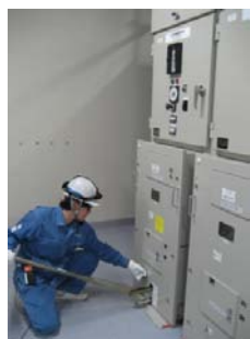
手順1:電源確保(6.6kVマック しゃ断器断路操作訓練)
