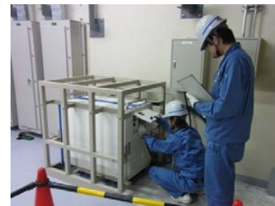
タービン動補助給水ポンプ非常用油ポンプ起動用バッテリー接続教育訓練
