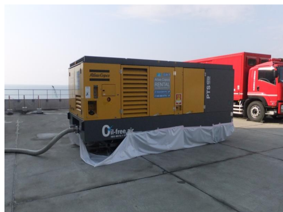
仮設コンプレッサー
