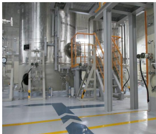
洗浄排水蒸留水タンク
