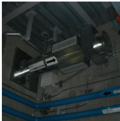
高圧注入ポンプ室給気口
