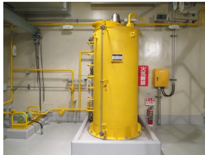
1次冷却材ポンプ電動機油回収タンク
