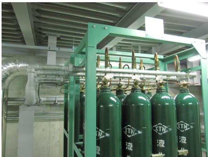
ディーゼル発電機CO 2 消火設備(原子炉建屋内) (イナートガス消火設備、ハロン消火設備も同様に 建屋内設置)
