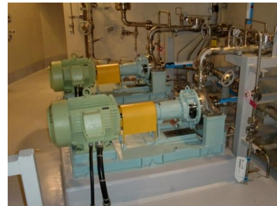
格納容器冷却材ドレンポンプ
