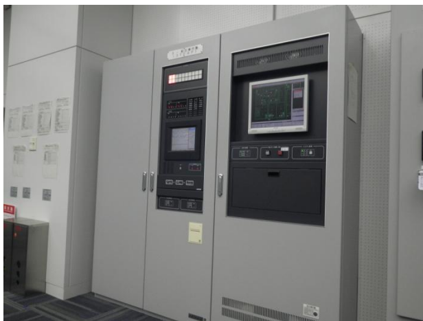
自動火災報知設備 受信機
