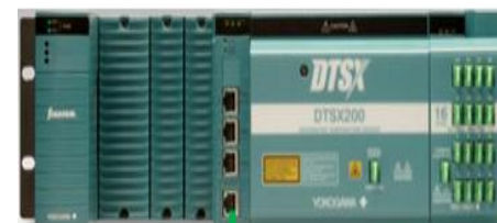
光変換器 (光ファイバ温度監視盤内設置)
