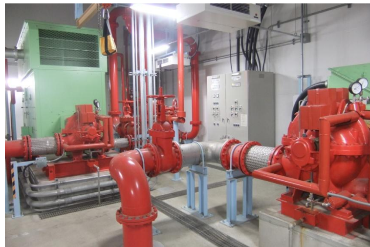
電動機駆動消火ポンプ ディーゼル駆動消火ポンプ (給排水処理建屋内)
