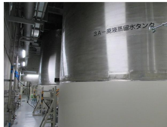
廃液蒸留水タンク
