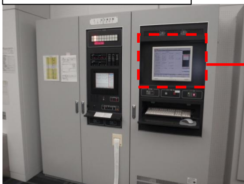
総合操作盤(中央制御室)
