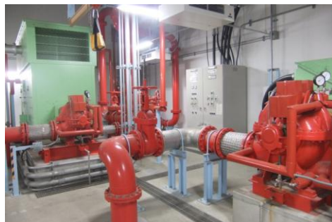
ディーゼル駆動消火ポンプ (給排水処理建屋内)
