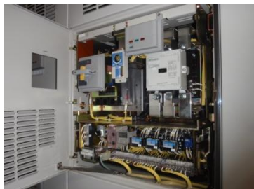
・機器:パワーコントロールセンタ ・種類:配線用遮断器
