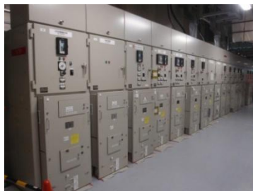
・機器:メタクラ ・種類:真空遮断器
