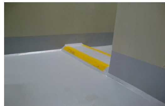
堰(ほう酸ポンプ室出入口)
