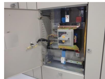
・機器:直流コントロールセンタ ・種類:配線用遮断器
