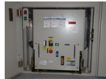
・機器:原子炉トリップ遮断器 ・種類:気中遮断器
