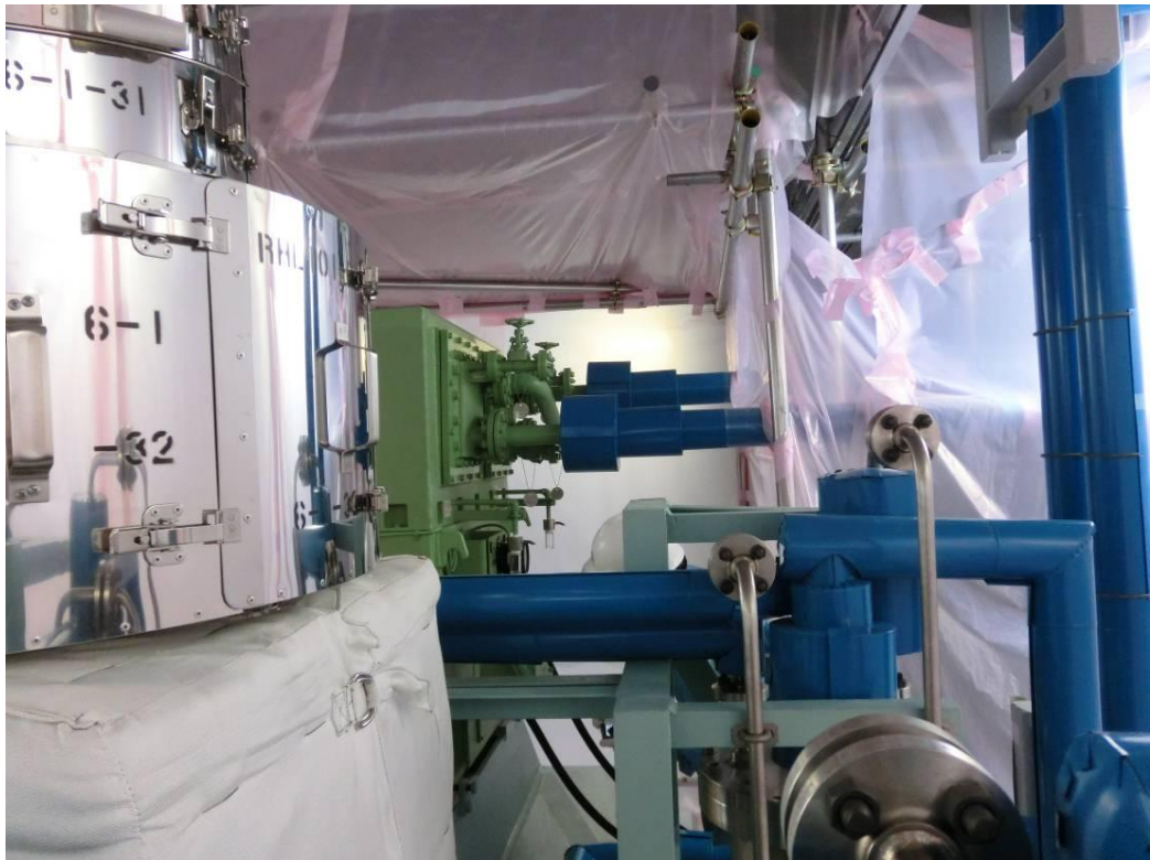
余熱除去ポンプ 周辺状況
