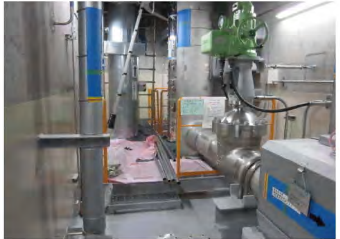
(2) B-安全補機配管室内
