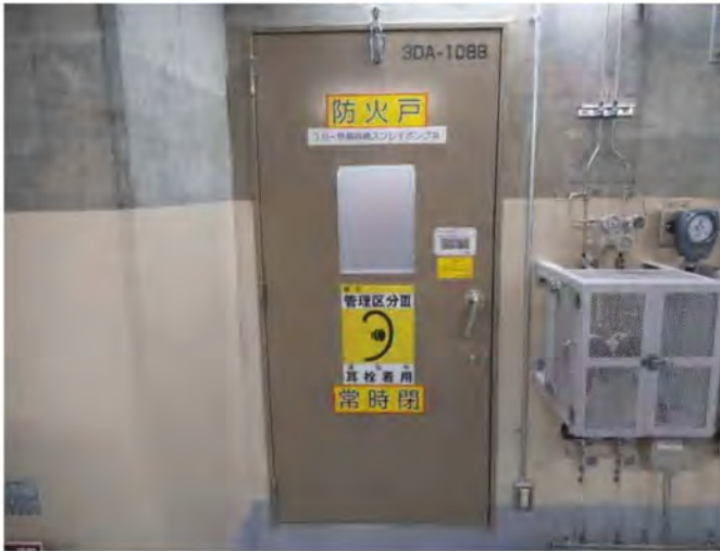
(7) B-格納容器スプレィポンプ室扉
