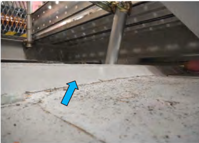
(3) B-安全補機配管室内の堰
