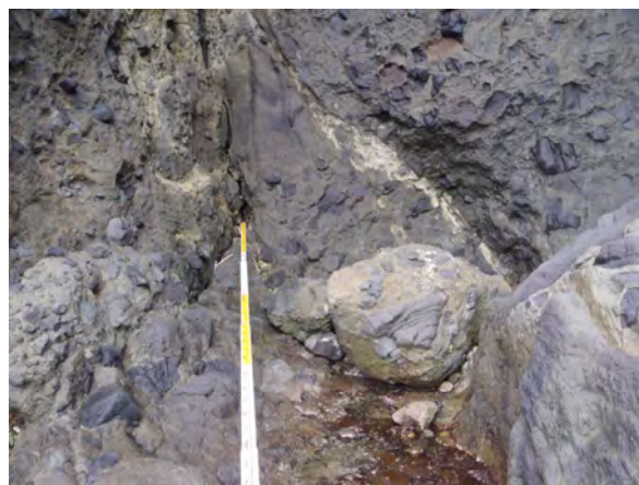
底面の状況(照岸②)
