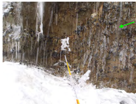
底面の状況(祈石北④)
